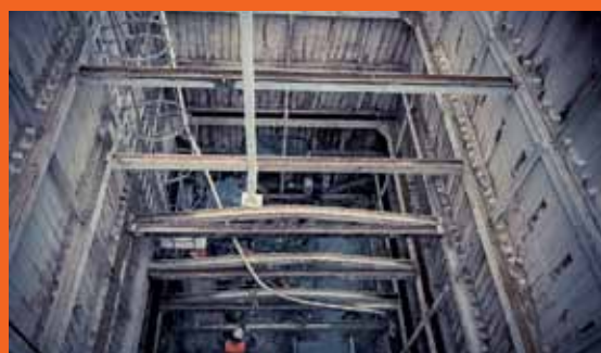
Ici, le futur accès pompiers Waldeck Rousseau qui permettra de relier le tunnel à la voirie. Fin des travaux prévue en 2018.
